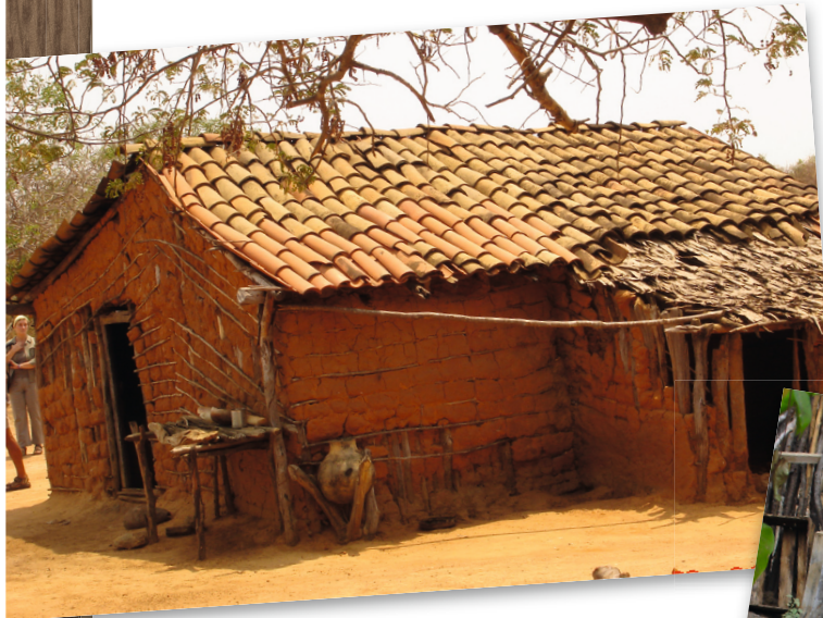
Renovierungsbedürftige Lehmhütte, Fotos: P. B. Hanke
